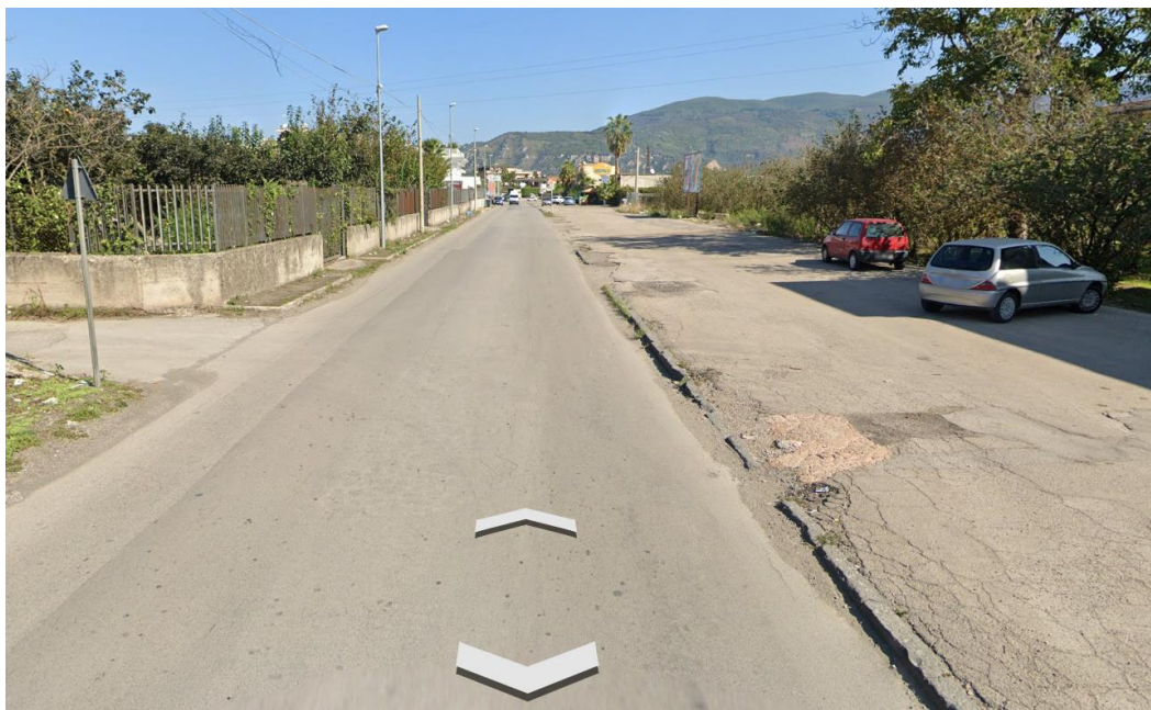
Figura n. 2 - Tratto degradato di via G. Iervolino oggetto di intervento
